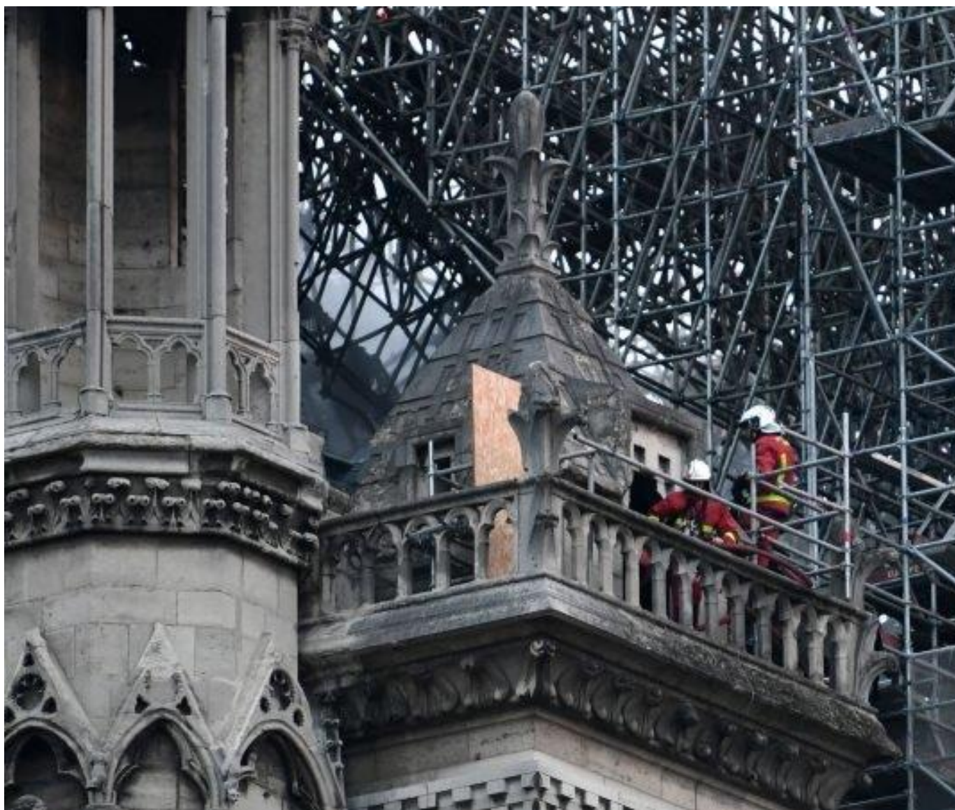
Feuerwehrmänner bei Löscharbeiten der Kathedrale Notre-Dame.
